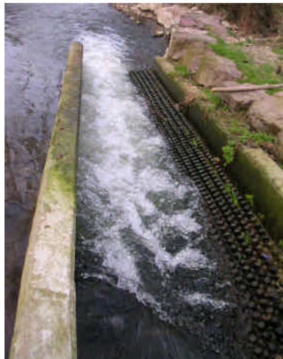
C54' :Rampe à anguille sur l'Odon ; Barrage du Mesnil à louvigny (14)
