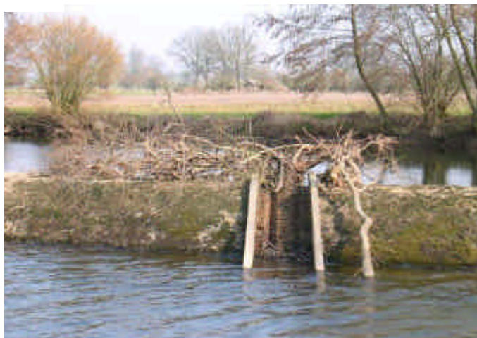
Mauvais état fonctionnel : Barrage du Hazé (O20) : la Mayenne
