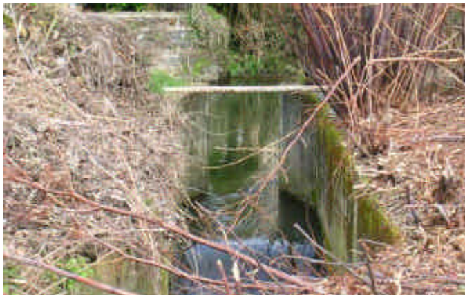
C44' : Exutoire de dévalaison sur l'Orne ; Microcentrale de la Fouillerie au Mesnil-Villement (14)
